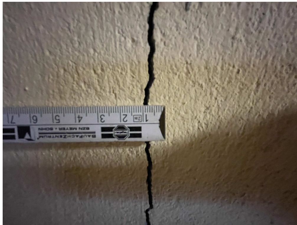
Vertikale durchgehenden Rissbildung
